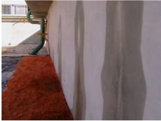
توضيح ارتفاع الشقوق مع ارتفاع الجدار البيتوني
