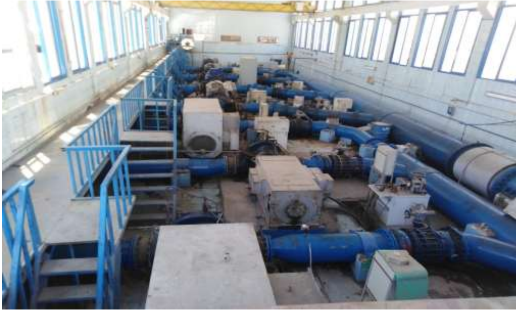
الشكل (3) يظهر صالة ضخ خط الجر الاول والثاني.
