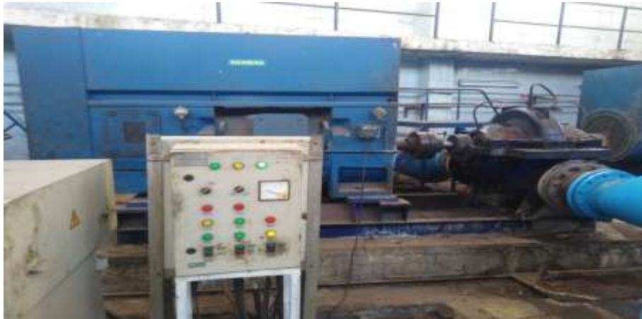
الشكل(7) يظهر مجموعة ضخ (مضخة ومحرك)
