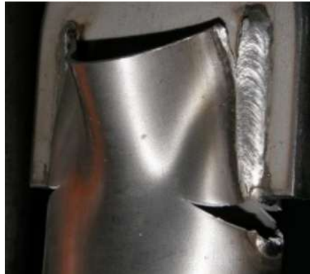
الشكل (5) - تشوهات المقطع CHS المشقوق والملحوم إلى صفيحة تجميع: انهيار بالتمزق عند أطراف منطقة الوصل عند استخدام لحام طولي قصير ومتوسط الطول، [11]
