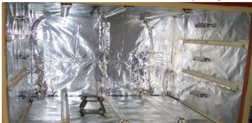
الشكل (2) الجهاز المصدر للأشعة فوق البنفسجية
