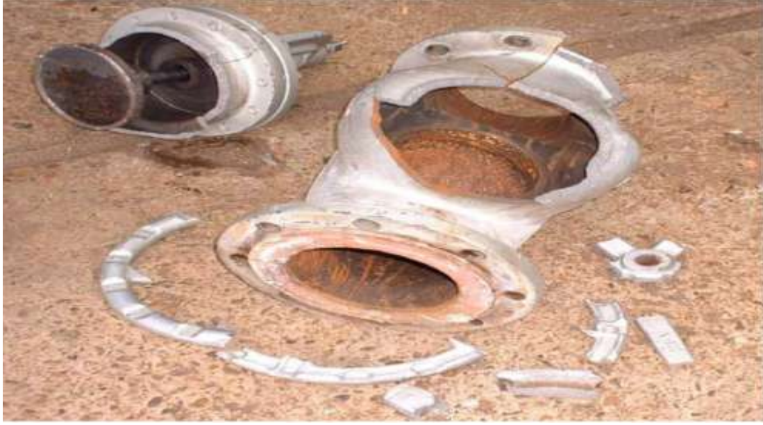
الشكل (1-1) صورة تظهر تحطم فلنجة وصل
