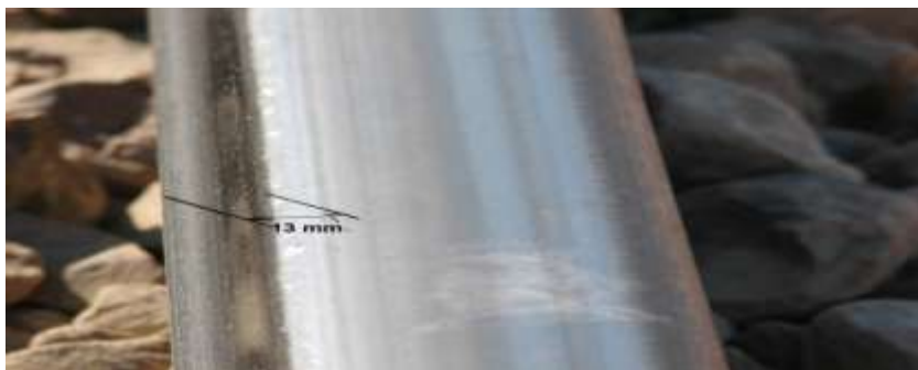
الشكل ( 7 ) : التآكل الجانبي للخط الحديدي
