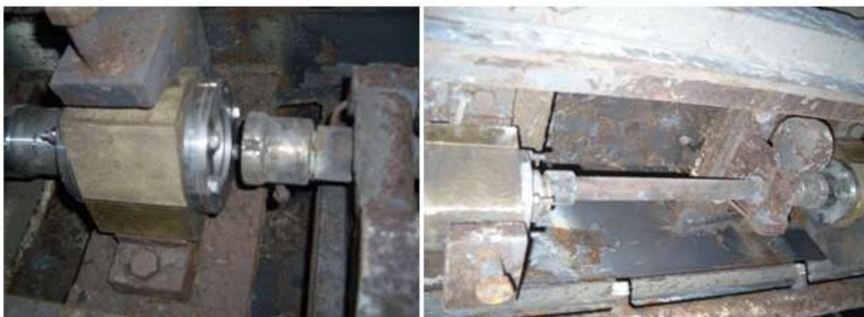
الشكل (3) يظهر توضع انابيب التوصيل داخل التيرمكس
