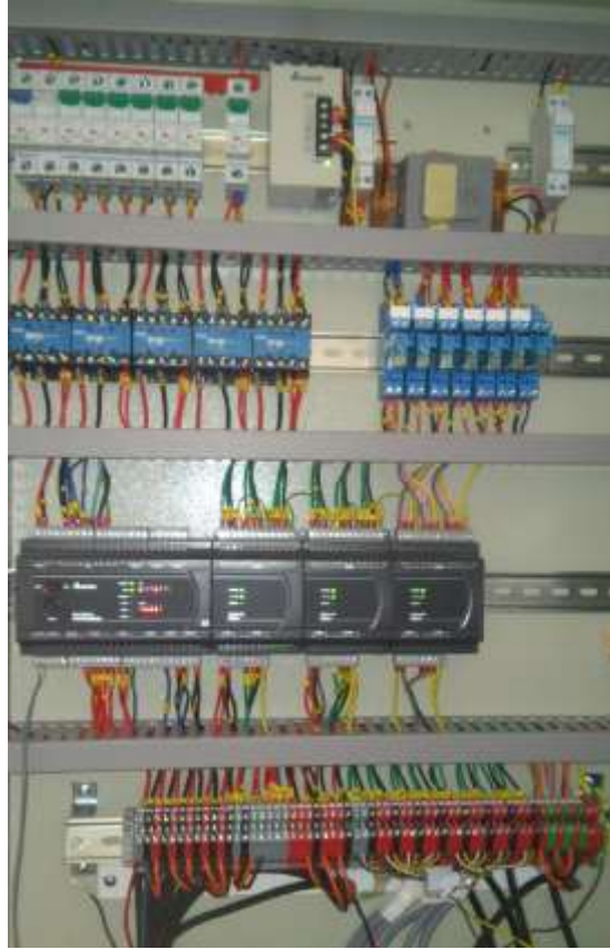
الشكل (11) لوحة التحكم الكهربائية
