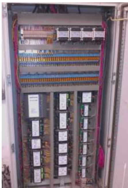
الشكل 4: لوحة تحكم لإحدى المنشآت.
