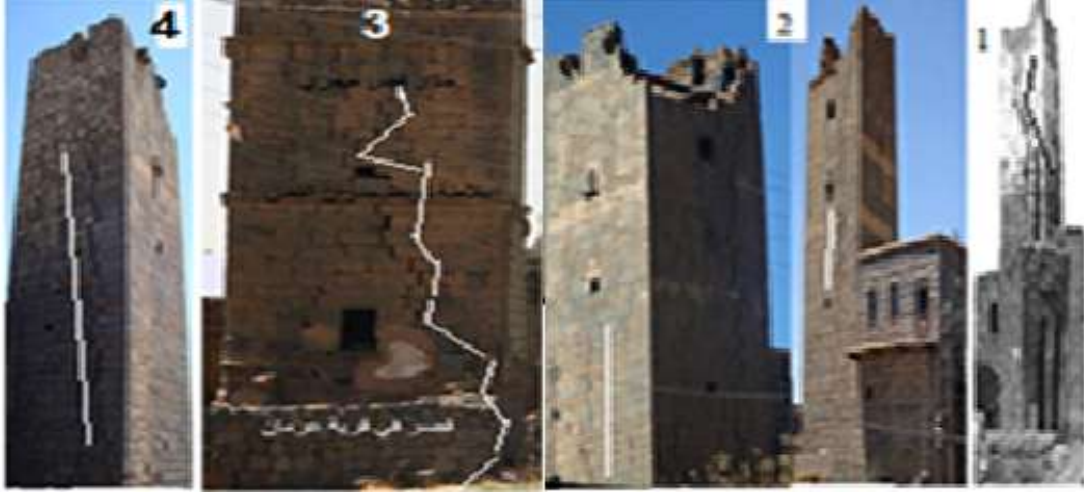
الشكل (4): يبين ظهور الشقوق في الجدران البازلتية. 1- برج بصرى الشام، 2- برج خزان المياه في مدينة القريا
