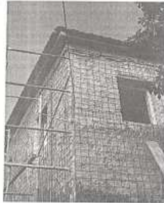
شكل (3): تقوية بناء حجري قديم أو متضرر باستخدام شبكة تسليح داخلي وخارجي مغطى بطبقة من البيتون الناعم [11]
