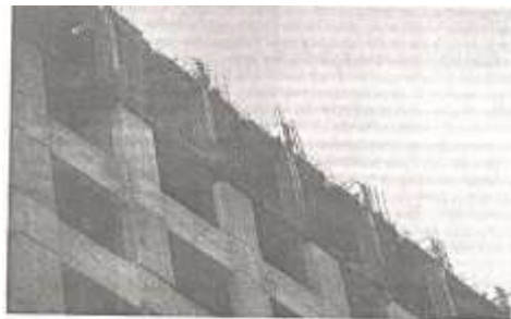
الشكل (9): تقوية بناء إيطالي عن طريق إحاطته بجملة من جدران القص (القصر العدلي في مكسيكو) [11]
