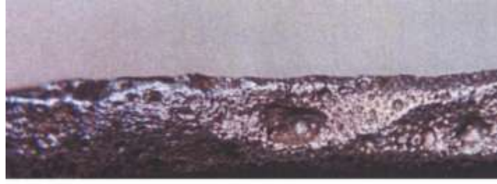
تآكل تنقري في قضيب الفولاذ
