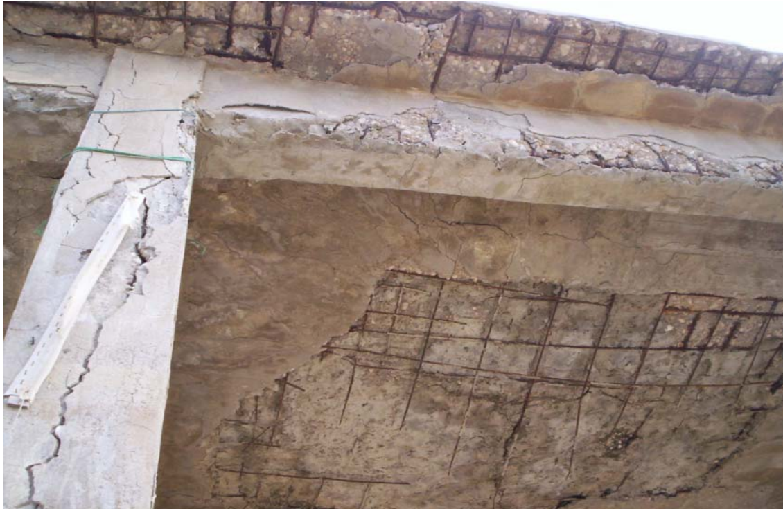
الشكل (1) التضرر الكبير في المنشآت البيتونية المسلحة نتيجة صدأ فولاذ التسليح
