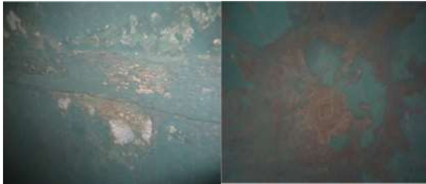
الشكل (11): مظهر التآكل في قبة برج التقطير الجوي.
