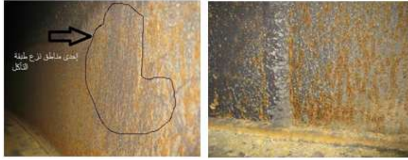
الشكل (6): بعض مناطق التآكل النكري في برج التقطير الجوي.
