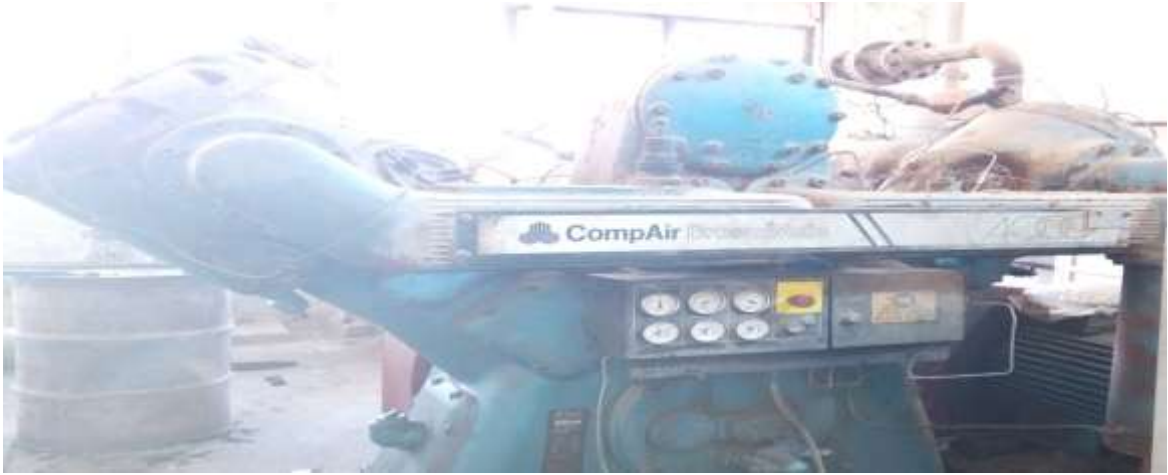
الشكل (1) ضاغط الهواء في معمل نترات الامونيا
